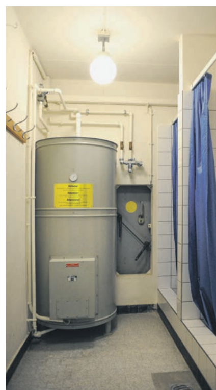
Der Boiler für Duschwasser wird nicht gefüllt.
